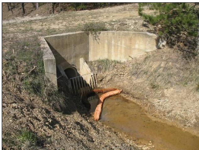
Exemple de boudins dédiés à l'absorption des hydrocarbures
