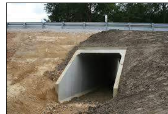
Figure 105 : Exemple de passage inférieur à petite faune, type pont cadre
