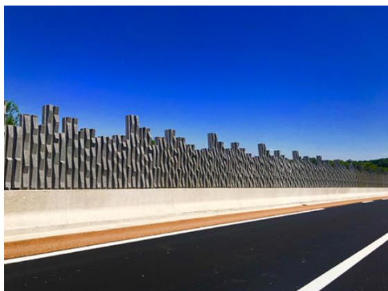
Ecran acoustique sur la RD613 déviation de Montagnac
